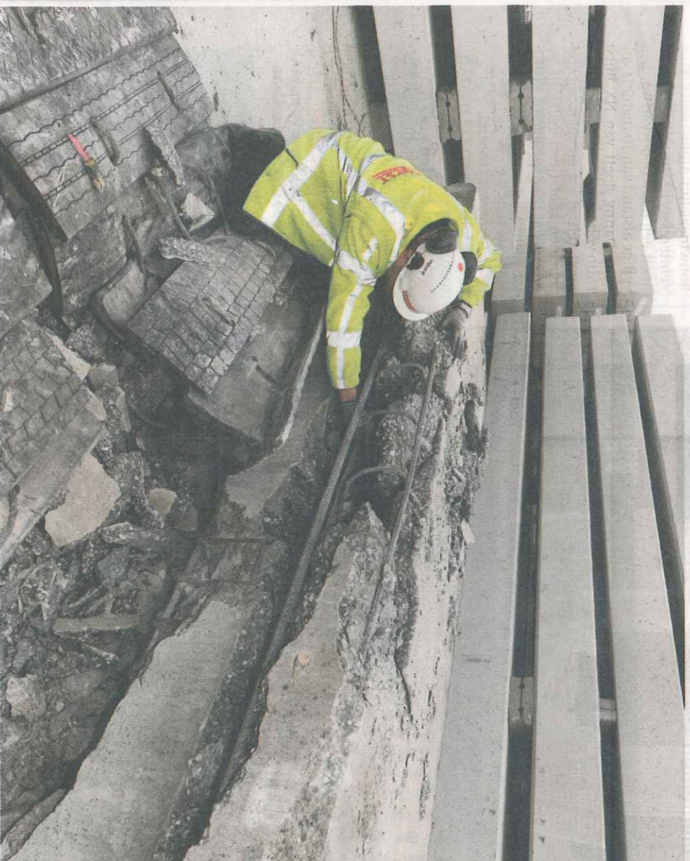
Ook een enkele wapeningsstaaf rond 32 millimeter blijkt te zijn doorgesneden door de NX Burst-patronen. Foto: s Ruud Ploeg
